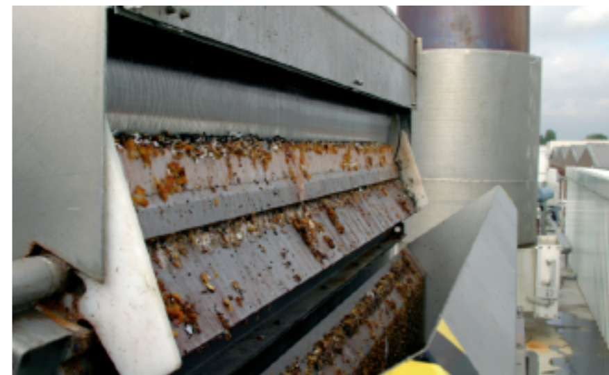
De anaërobe zuiveringinstallatie.
