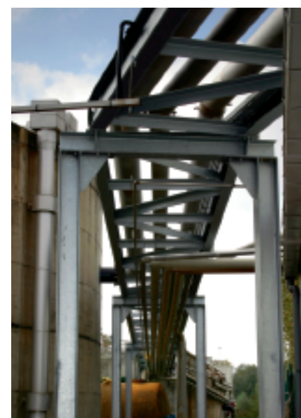
De verbinding tussen de aërobe en anaërobe reactor loopt over een afstand van vijftig meter. Dankzij een piperack wordt het afvalwater grotendeels gravitair getransporteerd.
